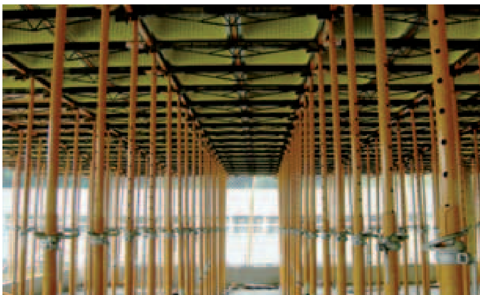
Puntal SP apeando Encofrado Recuperable Cubetas RECUB
