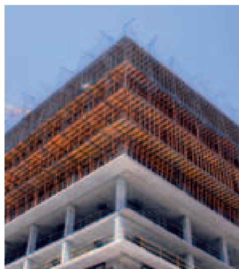
Edificio de viviendas realizado con encofrado RAPID y apeado con Puntal SP en Cerdanyola, Barcelona, España
